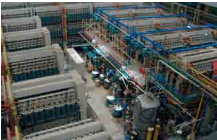
Сердце завода — газовые центрифуги
