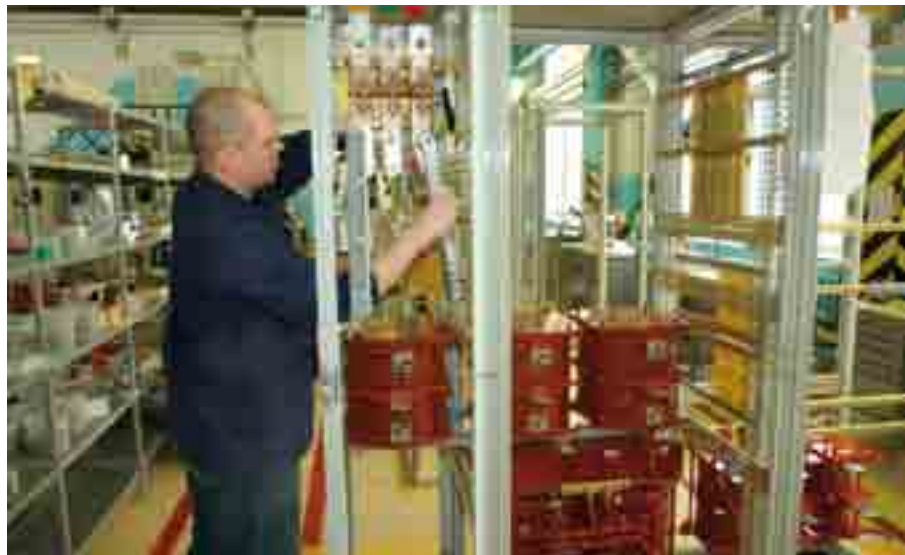
В 2005 году завершился окончательный переход схем электроснабжения основного технологического оборудования корпуса № 901 на новые источники питания
